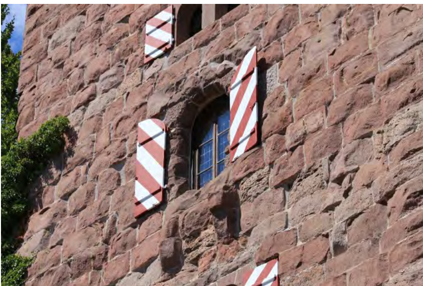
Wenngleich beschädigt, sind die beiden doppelten Konsolensteine noch gut erkennbar, die ehemals eine kleine Balkonfläche trugen.
